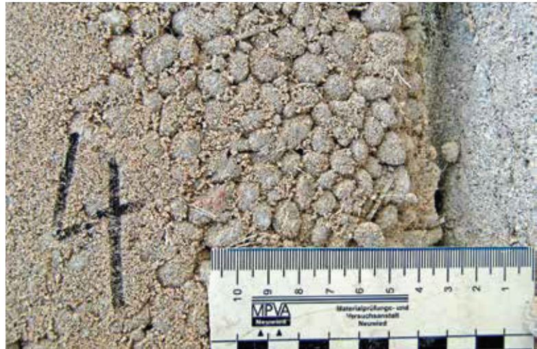
Reduzierte Verdichtbarkeit des Bettungsmörtels aufgrund einer zu geringen Menge an Zementleim.
